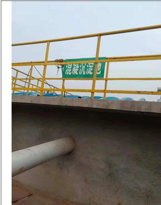
污水处理站-混凝沉淀池
