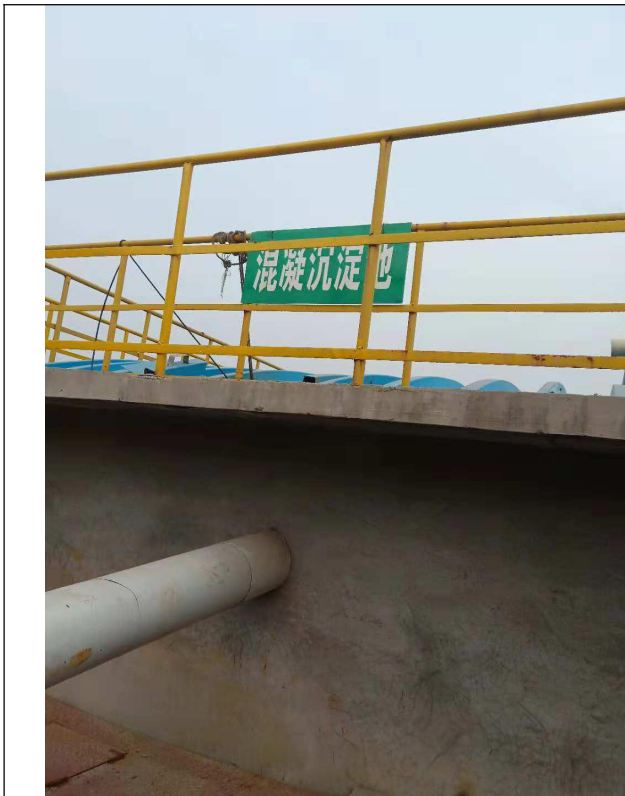
污水处理站-混凝沉淀池
