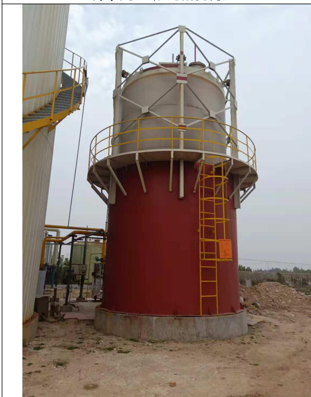
沼气回收缓冲罐
